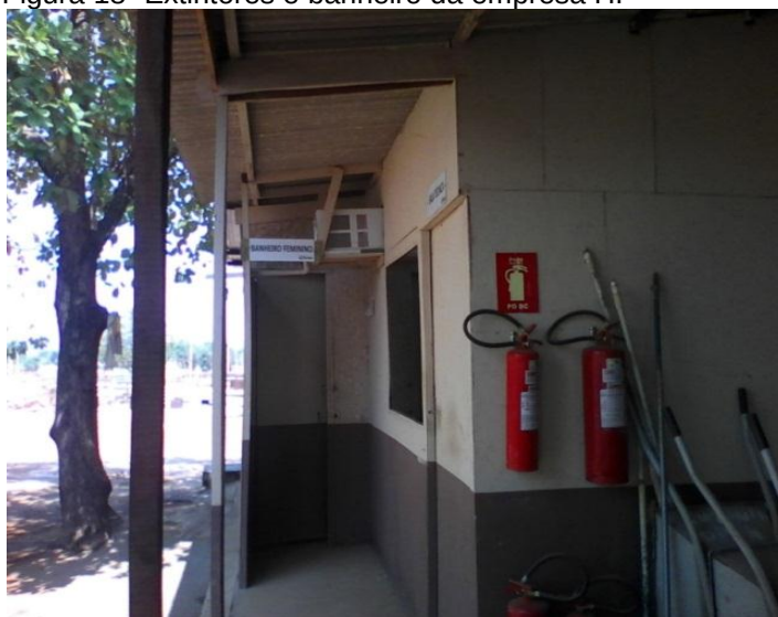
Figura 18 -Extintores e banheiro da empresa H.
