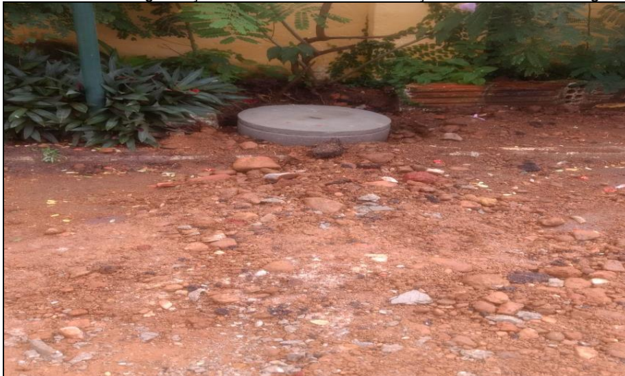
FIGURA 15 - Degradação do asfalto com a instalação do sistema de esgoto
