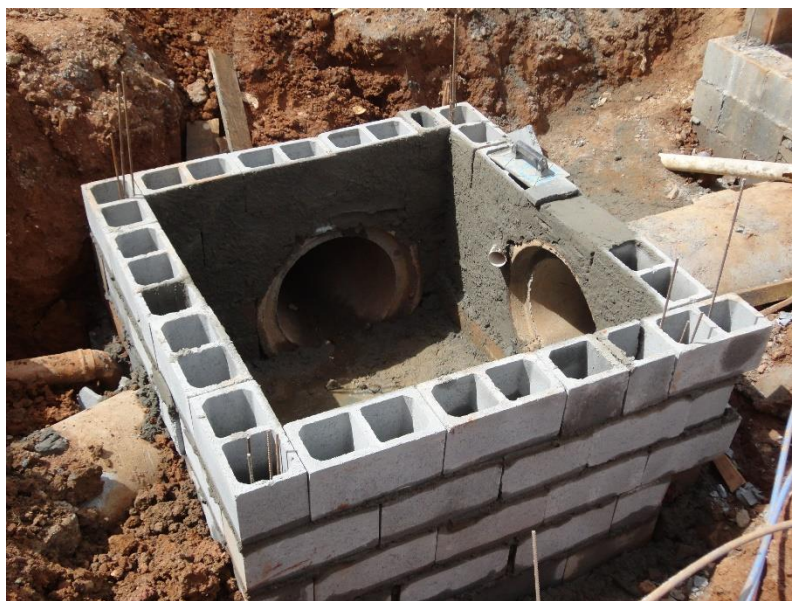
Figura 2 – Poço de visita
