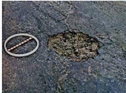
Figura 14 - Panela ou Buraco
