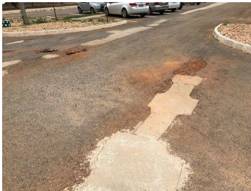
Figura 19 - Panelas ou buracos
