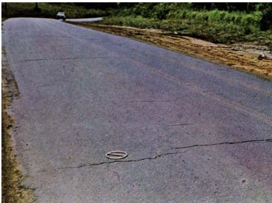
Figura 4 - Trinca Isolada - Transversal
