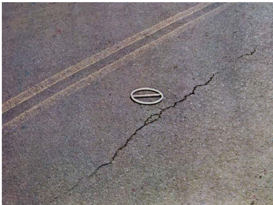
Figura 5 - Trinca Isolada - longitudinal
