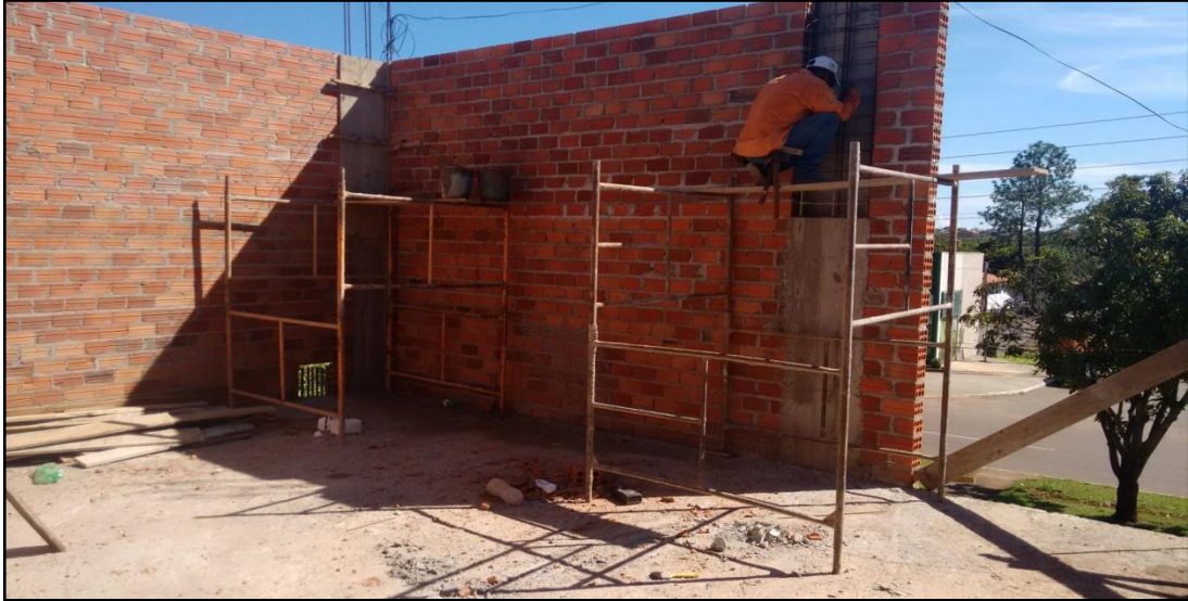
Figura 12-Transporte de materiais sem os EPI's necessários
