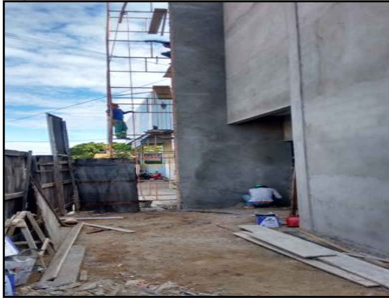
Figura 14- Trabalhador no andaime sem uso de EPI's.
