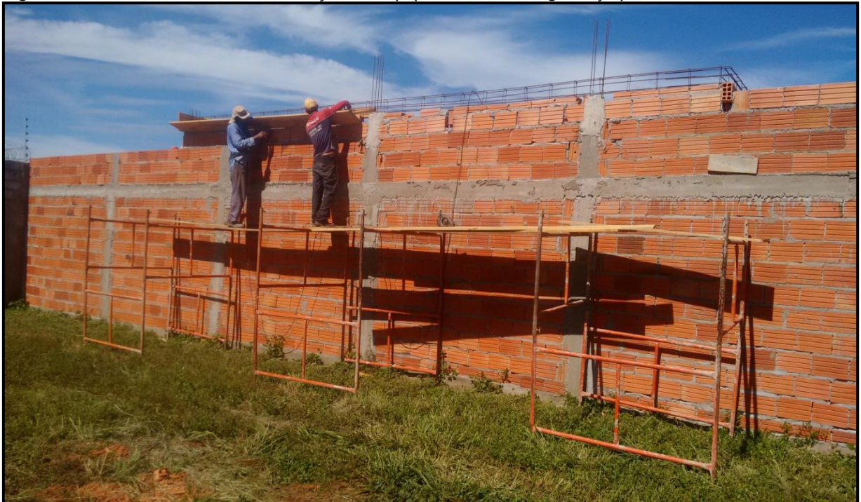
Figura 8 - Trabalhadores sem a utilização de equipamentos de segurança para o trabalho em altura
