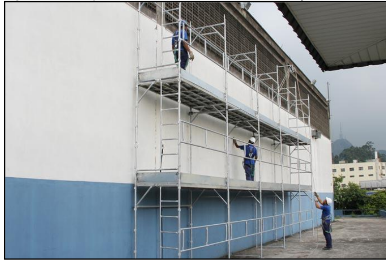
Figura 4- Exemplo de andaime utilizado na construção civil
