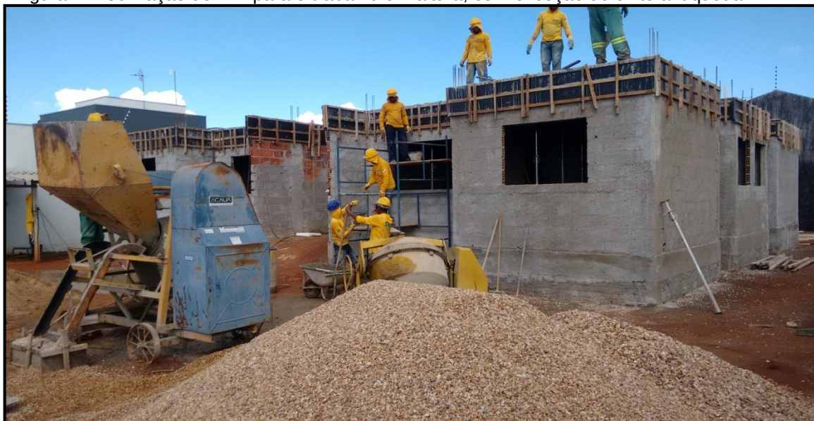
Figura 11- Utilização de EPI para o trabalho em altura, com exceção do cinto antiqueda
