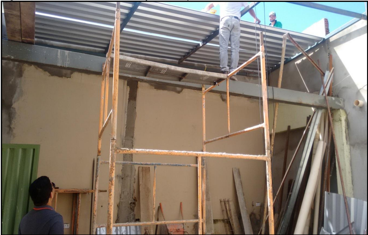
Figura 10- Trabalhadores sem a utilização de EPI para o trabalho em altura
