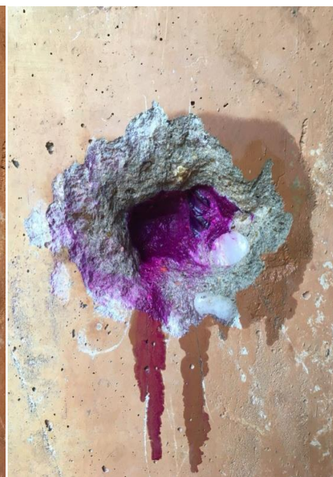
Figura 16 - Medição da Carbonatação Fonte: Autor(2018)
