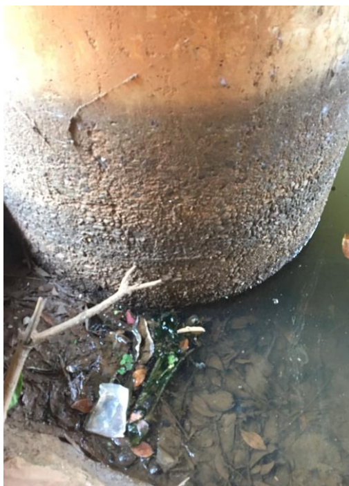
Figura 10 – Lixiviação no Pilar Fonte: Autor(2018)
