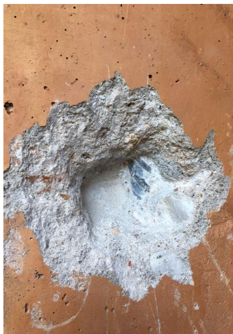
Figura 15 - Medição da Carbonatação Fonte: Autor(2018)
