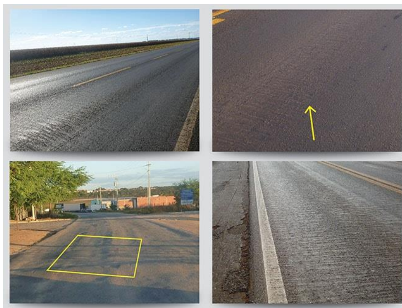
Figura 7: Ondulação ou corrugação do pavimento.
