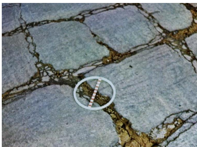
Figura 11: Trinca tipo “bloco”
