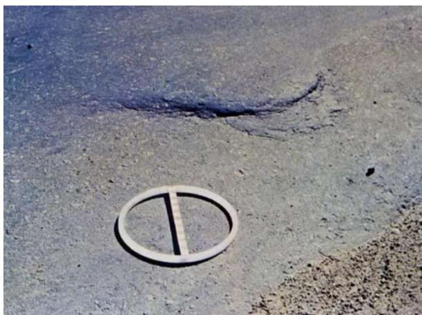
Figura 15: Escorregamento do Revestimento
