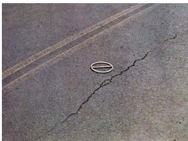
Figura 9: Trinca Isolada Longitudinal
