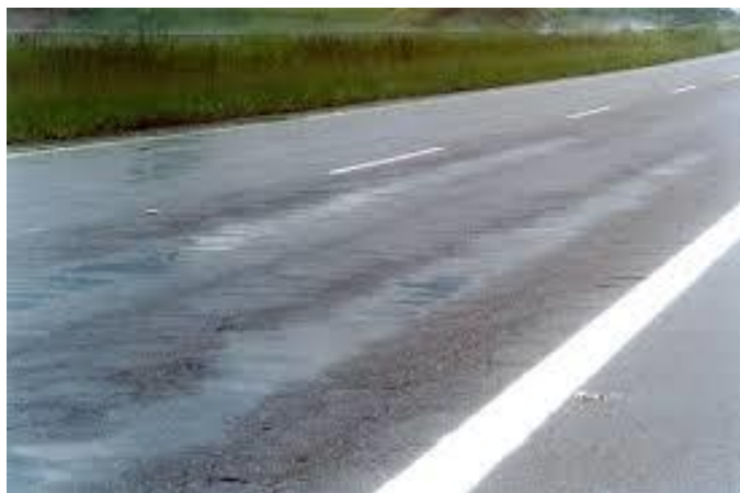
Figura 6: Afundamento do asfalto.
