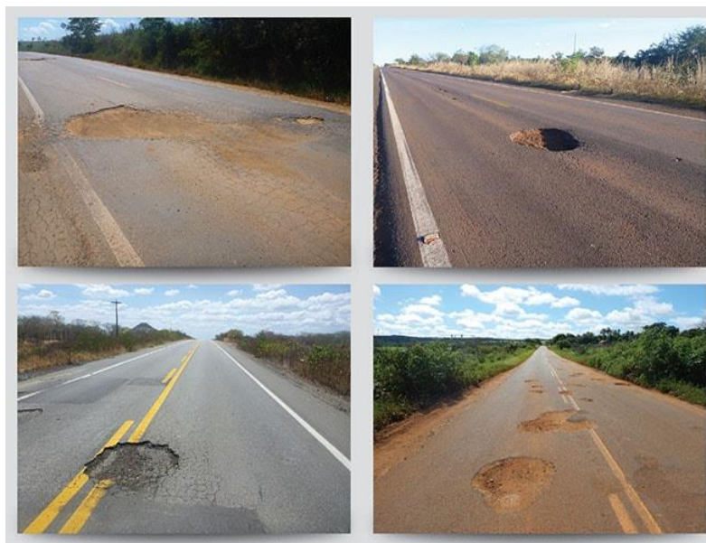
Figura 14: Painelas no revestimento asfáltico do pavimento.
