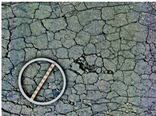
Figura 10: Trinca Interligada “couro de jacaré”
