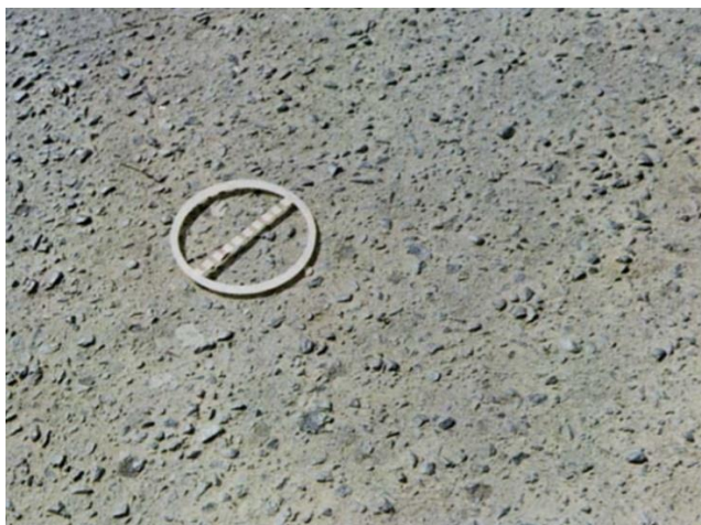
Figura 13: Desgaste do pavimento
