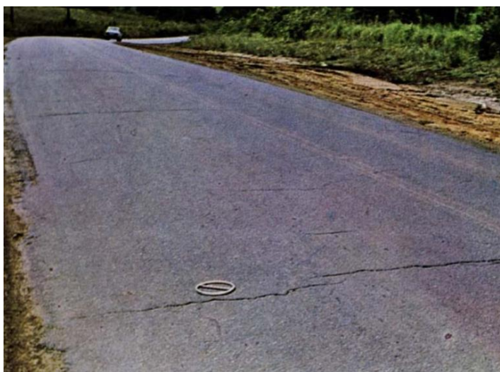
Figura 8: Trinca Isolada Transversal.
