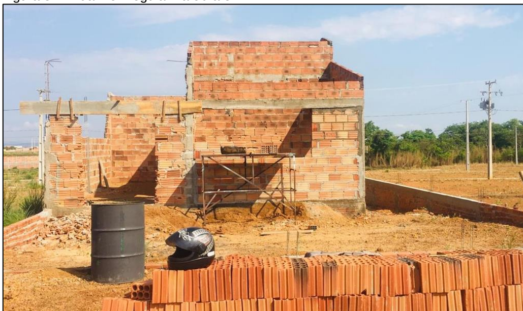
Figura 3 - Andaime irregular na obra 3.
