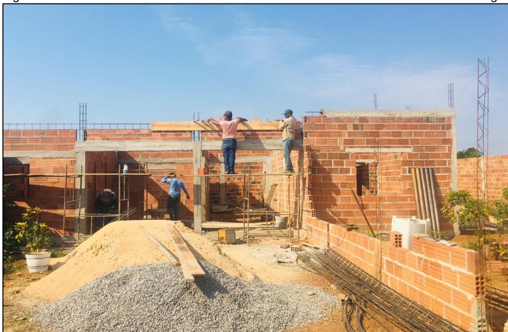
Figura 2 - Trabalhadoras da obra 1 realizando trabalhos em andaimes de modo irregular.
