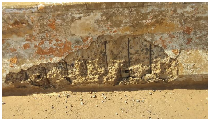
Figura 06: Perda de cobrimento e exposição da armadura. Fonte: Autores.
