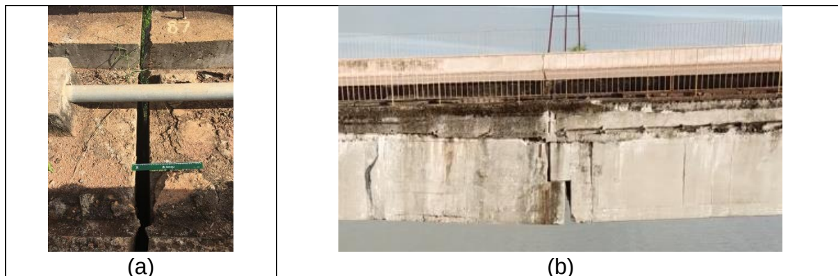
Figura 03: deslocamento e fissuras de cisalhamento no dente gerber. Fonte: Autores.
