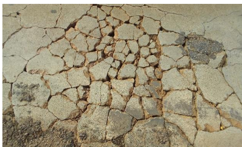
Figura 04: Fissuras e trincas. Fonte: Autores.
