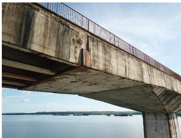
Figura 07: Deslocamento no dente gerber.
