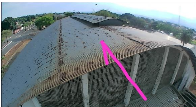
Figura 8. Telhado com perfurações e ferrugens
