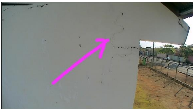
Figura 7. Fissuras e trincas
