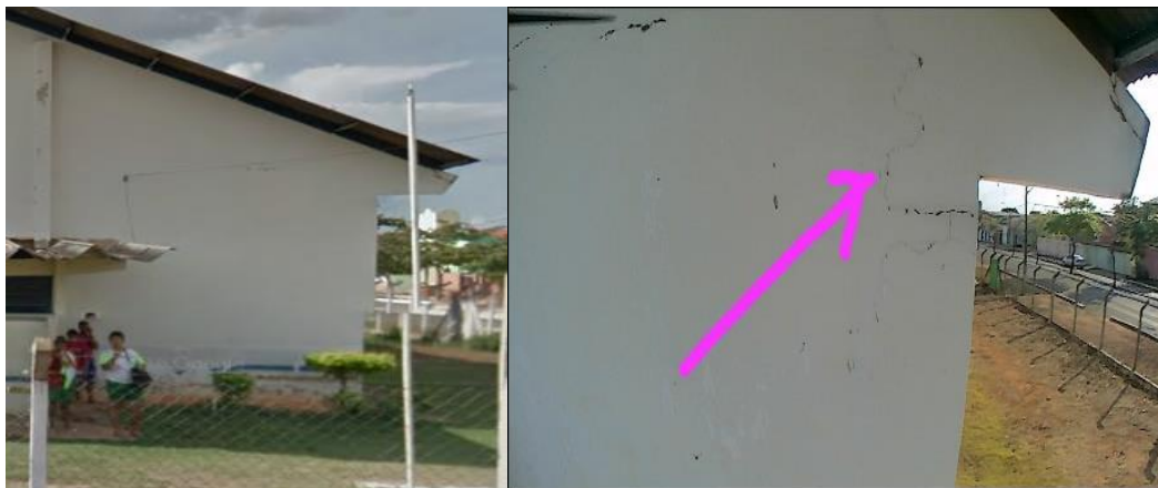
Figura 5. Manifestação de fissura
