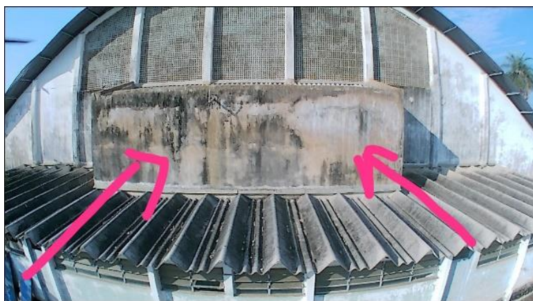
Figura 7. Manchamentos e eflorescência
